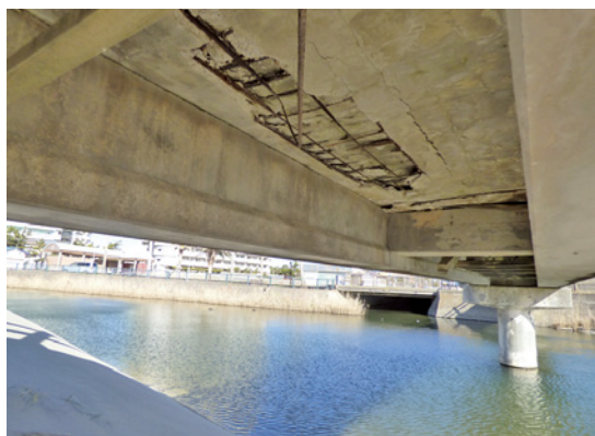
▲劣化が進んでいる砂丘橋の床版下部
