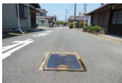
▲道路内にある防火用水（鉄板蓋）
