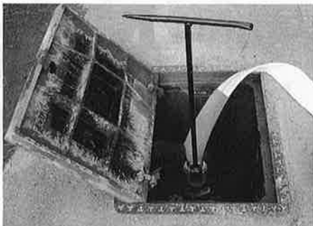
ホースをつなぎ筒先を装着し開栓棒によりゆっくりと栓をあける
