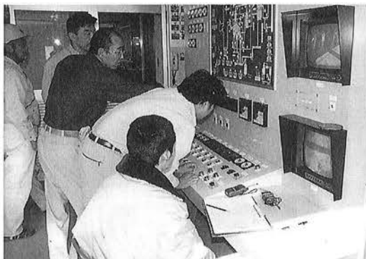
今年の十一月に完成した町清掃センター ごみの焼却運転を集中管理する事務室では、燃焼状況や温度などを常に確認し、運転しています。
