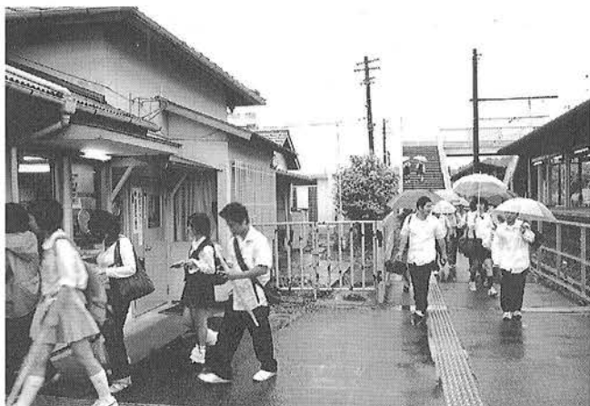
改札口からホームまでの屋根設置工事がはじまります
