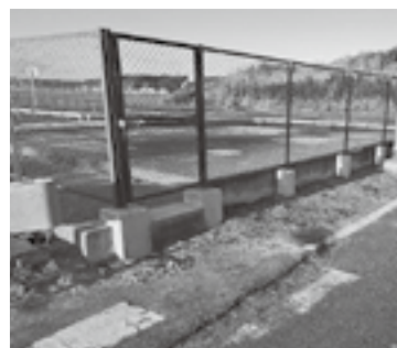
▲塚川生活排水処理施設
